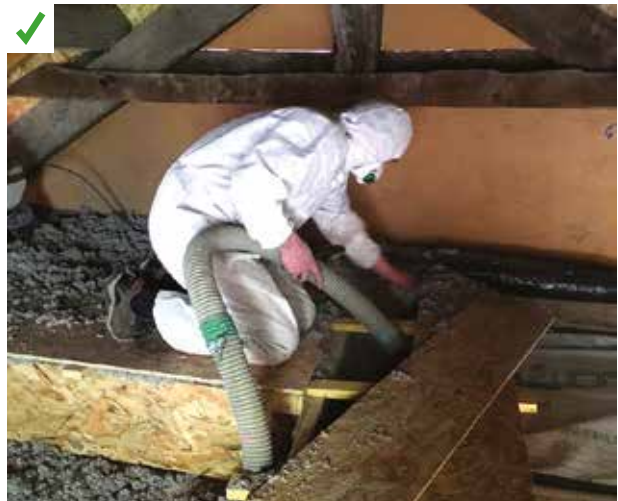
Mise en place d'un cheminement technique pour accéder au groupe de ventilation. L'intérieur du caisson est isolé. ©AQC
