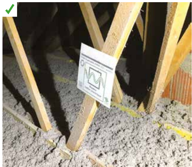
Une affiche de repérage, fournie par le fabricant, a été placée sur un élément de charpente pour repérer un boîtier électrique étanche situé à l'aplomb. ©AQC
