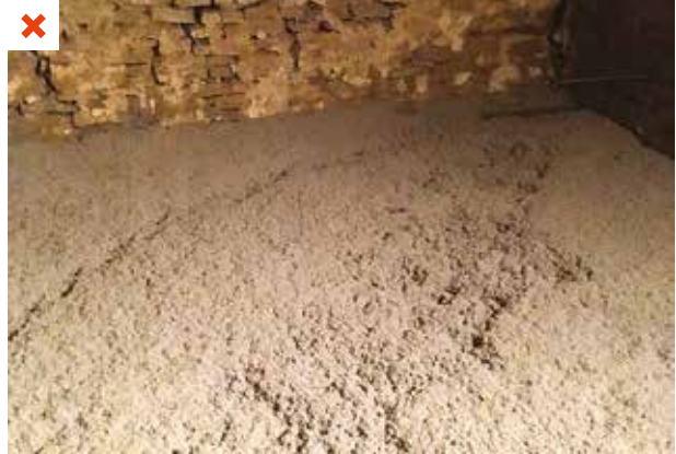
L'isolant a été endommagé suite à l'inspection du comble par le propriétaire. ©AQC
