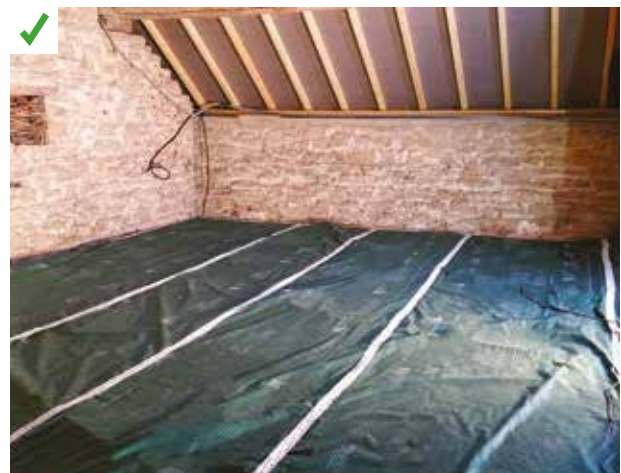
Le traitement de l'étanchéité à l'air a été effectué sur le plancher, avant de recevoir l'isolant. ©AQC
