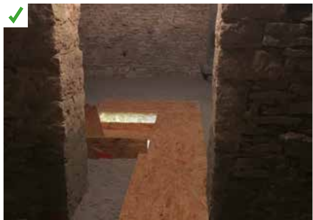
Le cheminement technique permet d'inspecter l'ensemble du comble et d'intervenir aisément. ©AQC
