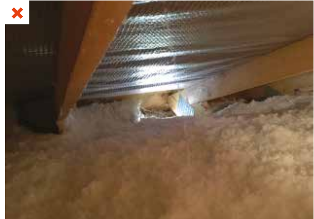
Cette entrée d'air, improvisée pour pallier l'absence de ventilation suite à l'isolation du comble, n'est ni adaptée, ni pérenne. L'isolant non retenu risque de l'obstruer à terme. ©AQC
