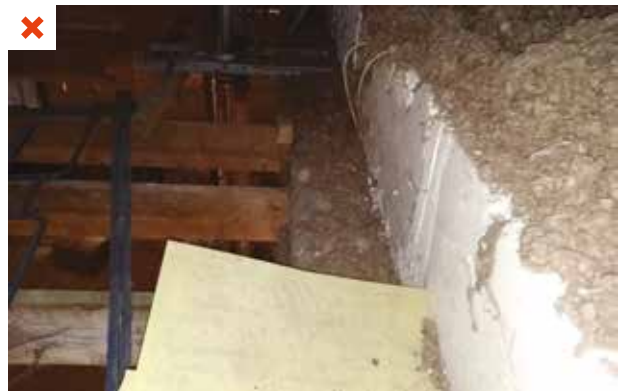
Aucune rehausse périphérique n'a été mise en place pour contenir l'isolant. ©AQC
