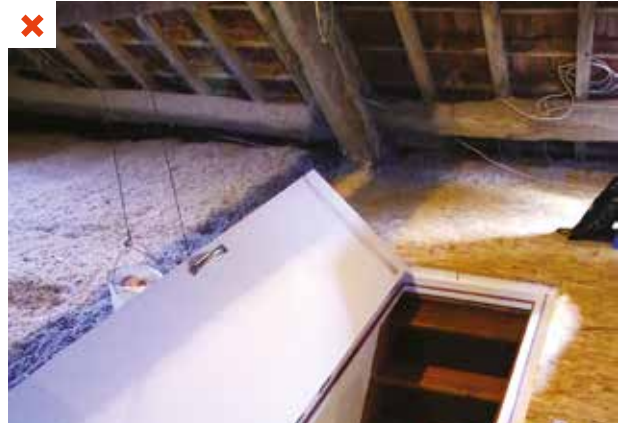
Trappe d'accès aux combles non-isolante. ©AQC
