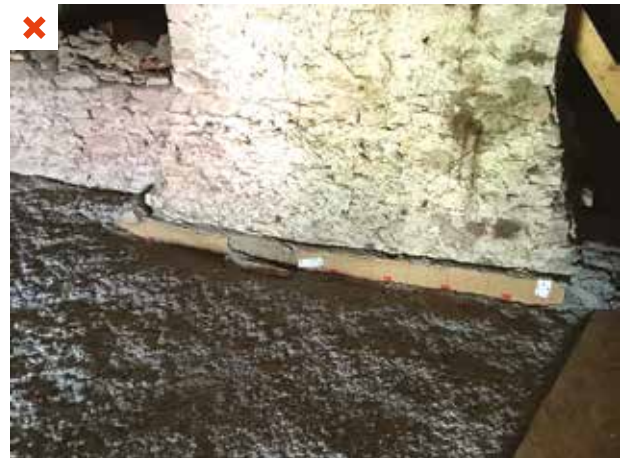
Absence de coffrage rigide et non respect de la distance de sécurité. L'isolant non combustible mis en œuvre ne permet pas d'assurer la distance nécessaire. ©AQC
