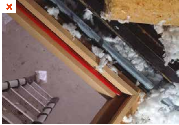
Trappe d'accès à un comble sans maintien de l'isolant sur le pourtour. ©AQC
