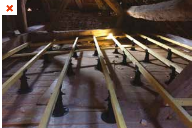
Le plancher bois du comble va recevoir l'isolant mais il n'est pas étanche à l'air. De nombreux passages d'air existent entre les lames. ©AQC
