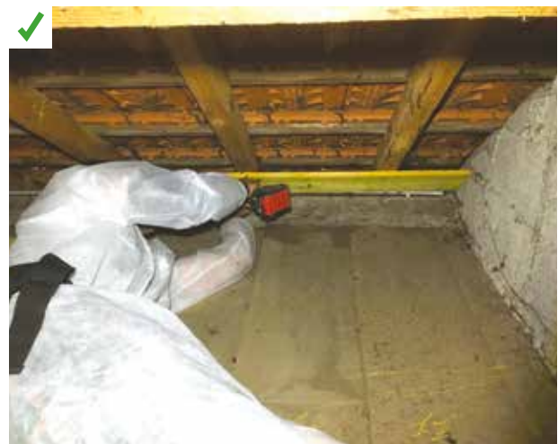
Mise en place de déflecteurs en bas de toiture pour maintenir la continuité de la lame d'air ventilée sous les tuiles. ©AQC
